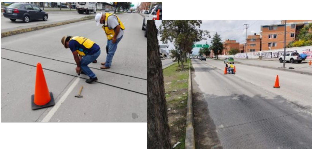
Imagen 1. Instalación de Equipos de Aforos Automáticos.
